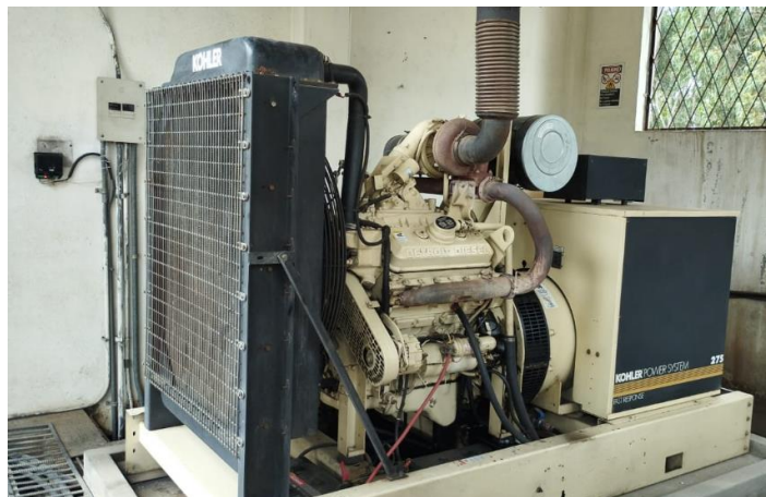
Figura 4. Generador Planta de Agua El Cebollar
