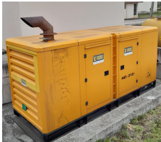
Figura 6. Generador Tixán Modulo 2
