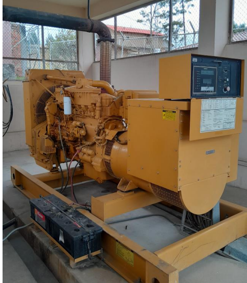
Figura 5. Generador Tixán Modulo 1
