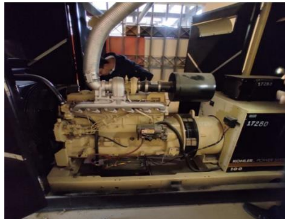
Figura 11. Generador de las Oficinas de Recaudación (Gapal)
